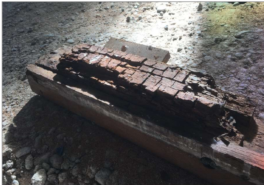
Angefauter Holzbalken, welcher das Podest der Kirchenbänke getragen hat.
