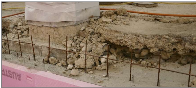
Nicht armerter Betonboden, welcher für die Verlegung der neuen Keramikplatten untauglich ist.
