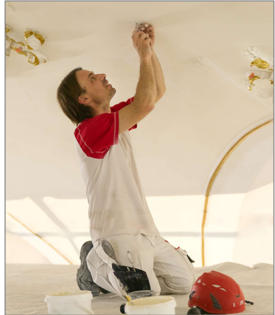
Josua Bolt bringt den Deckputz auf und glättet diesen im richtigen Moment ab.
